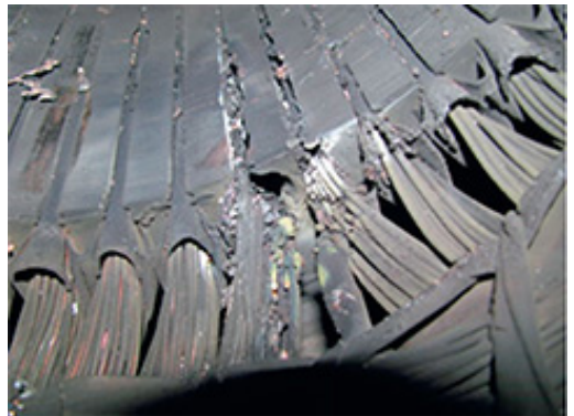
Figura 1. Núcleo con daño severo.
